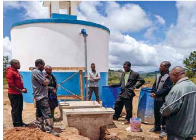
Wasserspeichertank in Lupombwe
